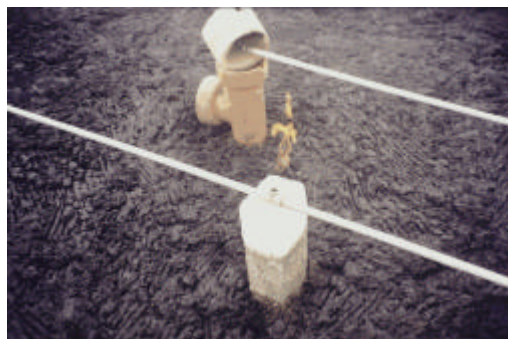
Figura 3 - Queima do biogás em leito de secagem
