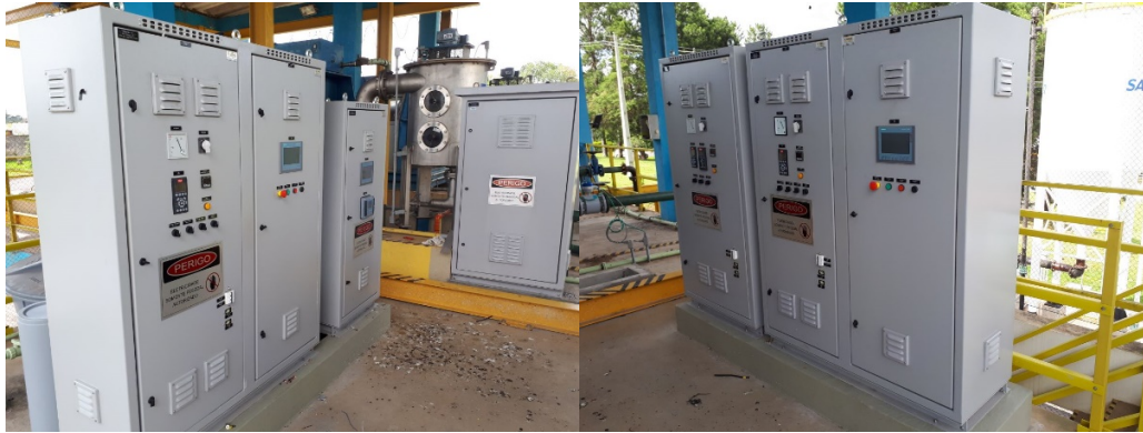
Painéis das Contipress 01 , 02 , Bombas de lodo, e Equalização de lodo
